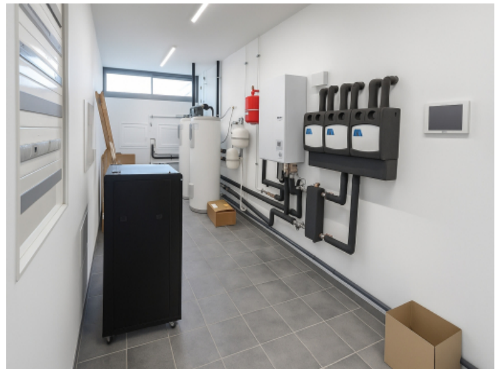
Technikraum im Erdgeschoss
